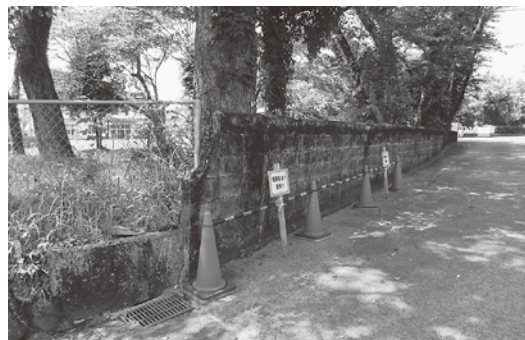
▲学校周辺の危険なブロック塀
