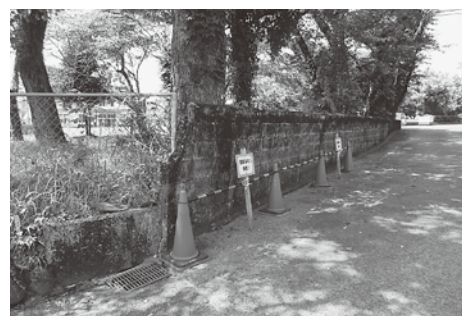
▲改修を要するブロック塀
