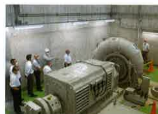
酒谷発電所（日南市）
