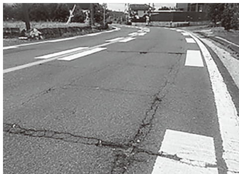
▲町道二葉並木線の舗装ひび割れ状況
