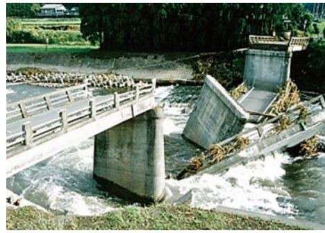
平成 5年 蒲牟田橋(町道)流出
