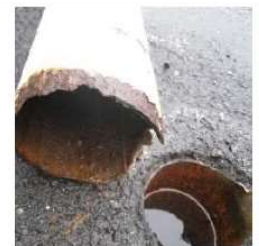
ポール看板の倒壊
