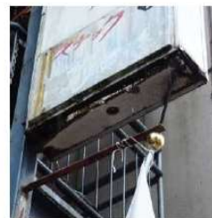
袖看板の底部脱落
