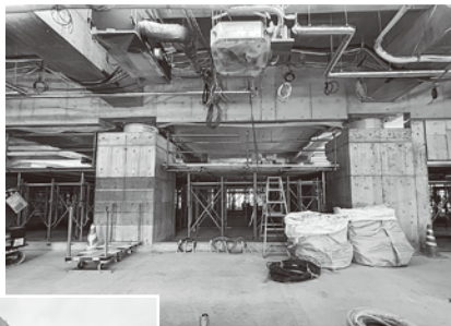
▲新庁舎耐震性能の要となる免震装置
